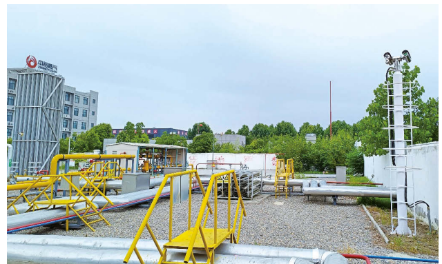
雲台激光式天然氣洩漏監測系統
