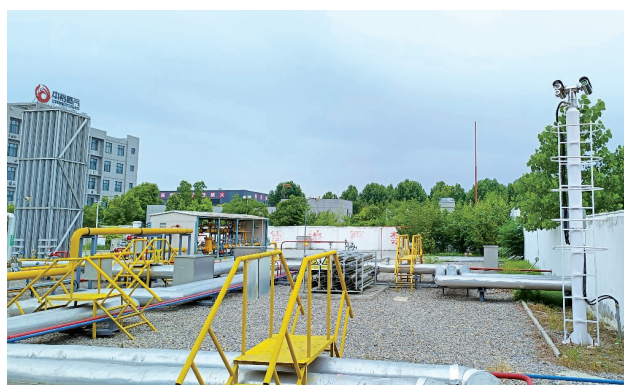
雲台激光式天然氣洩漏監測系統
