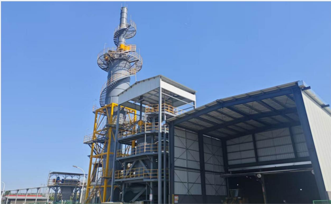
绵阳双汇项目 投运装机量： 25t/h
