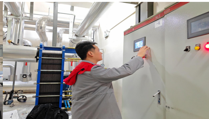
电控设备调试
